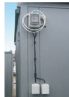
Детайл на електроинсталацията.
